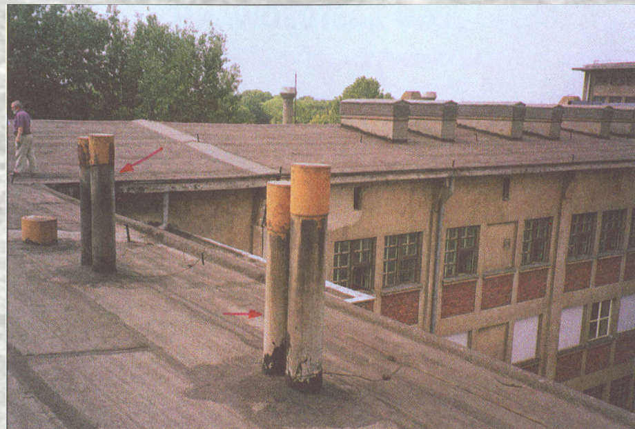
Instalacja wentylacji grawitacyjnej w obiekcie przemysłowym wykonana z rur azbestowo-cementowych
