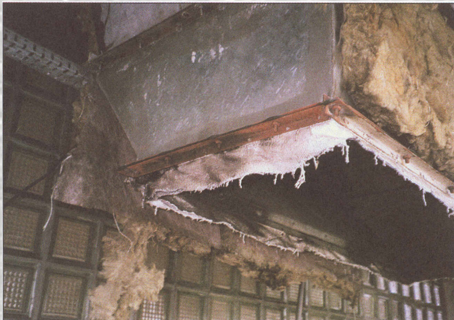
Płótno azbestowe w przewodach wentylacyjnych
